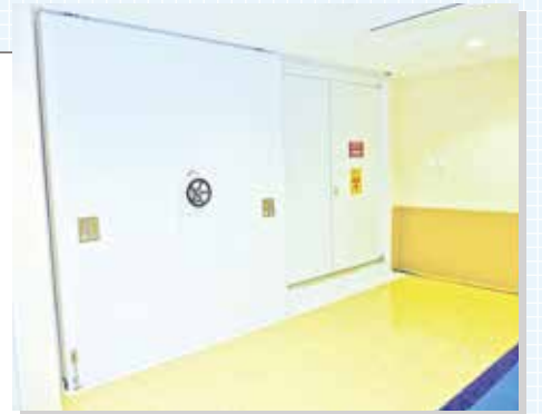
他病院リニアック室の水密扉の事例 (画像提供:株式会社久米設計)
