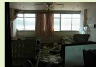
津波被害を受けた院内
